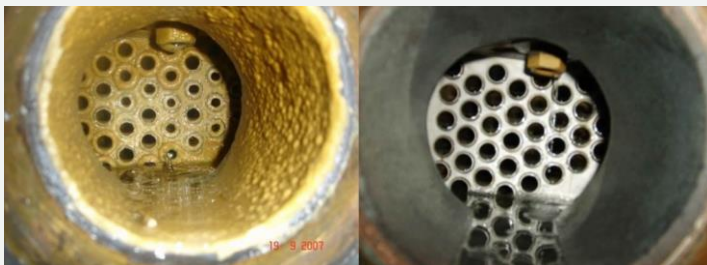
Foto: Depósitos formados en el interior de una caldera
